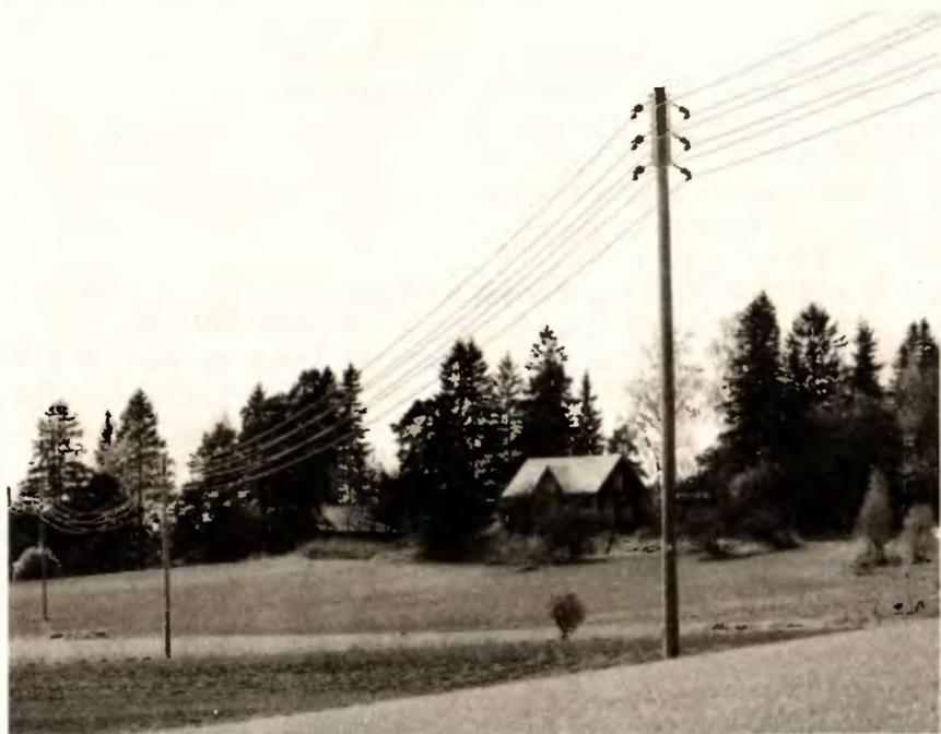
Рис. 13.39. Двухцепная линия напряжением 6...10 кВ (промежуточные опоры)
