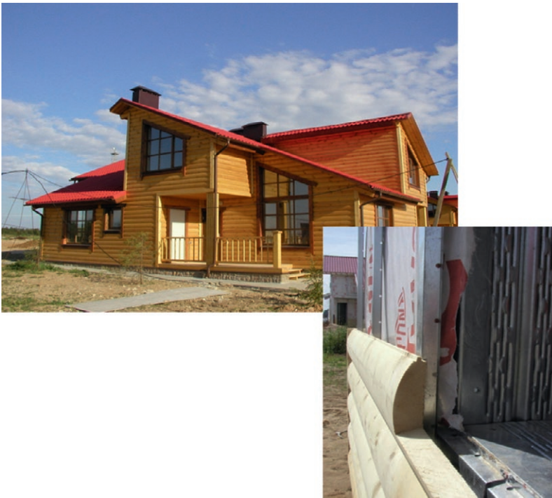
Облицовка деревянными досками типа «блок-хаус» по форме и конфигурации напоминающей деревянный брус
