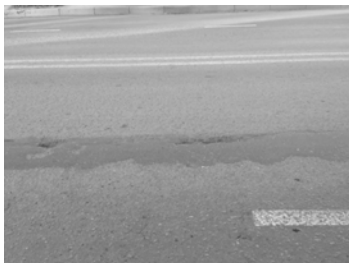
Рис. 4.2. Разрушение дорожного покрытия на стыке смежных полос
