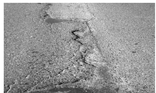
Рис. 2.6. Динамика развития разрушения дорожного покрытия в зоне стыка полос
