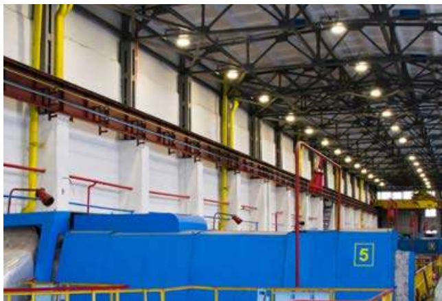
Рисунок 2.2.1.1 Рабочее освещение производственного цеха
