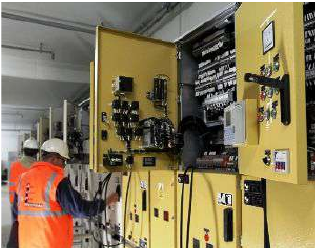
Рисунок 5.3.1.2 Наладка релейной защиты высоковольтных ячеек
