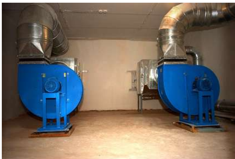
Рисунок 2.3.4.15. Внешний вид вентиляционной системы.
